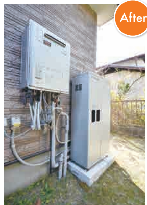
▶ 省スペースに設置可能なエネファーム
